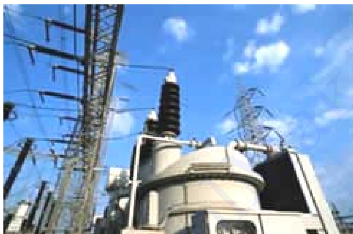
شکل(1-5): ترانسفورماتور قدرت HTS
